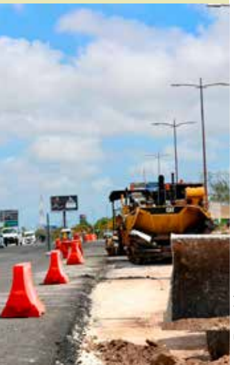
El bulevar Colosio y el Distribuidor Aeropuerto llevan más del 40% de avance.
