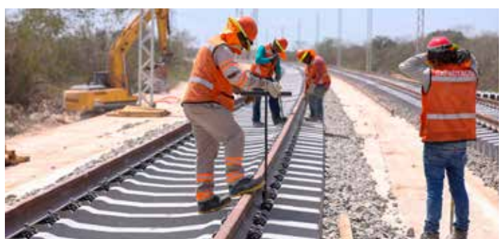
Las obras del Tren Maya acaparan la mano de obra calificada en Chetumal.
