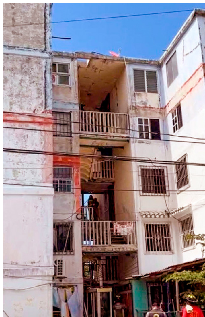
■ Hace unos días colapsó la escalera de un edificio en Corales.
