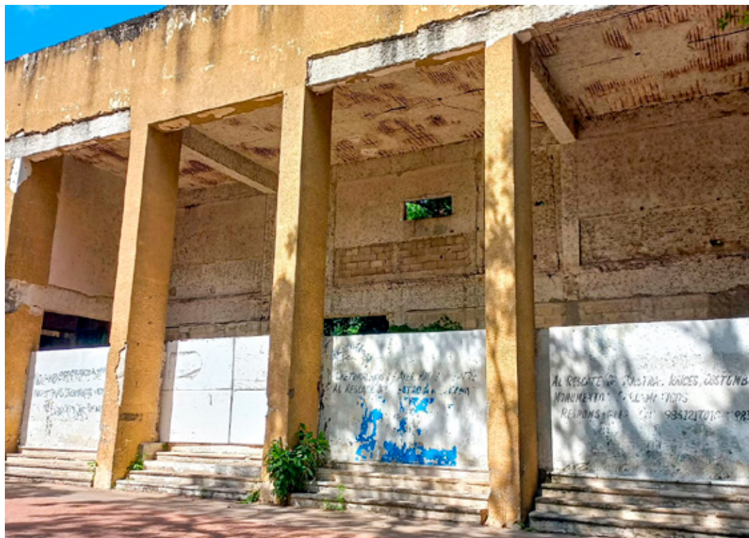
Así se encuentra actualmente el teatro 'Manuel Ávila Camacho' en Chetumal.
