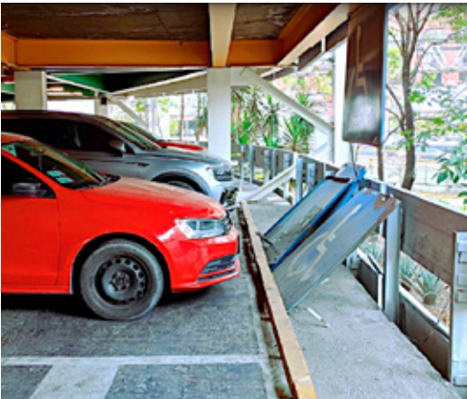
■ Grietas y desperfectos son visibles en varias zonas del aeropuerto.
