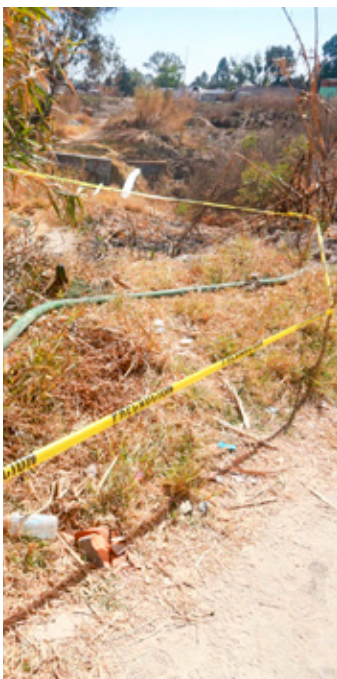
■ Los tramos perforados son por tomas clandestinas del hidrocarburo.
