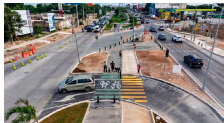
Foto: Especial En la Avenida Huayacán se implementó un nuevo sistema semafórico para incrementar el flujo vehicular.
