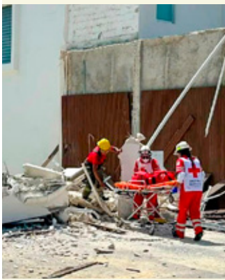
Sigue abierta la investigación sobre la caída de la estructura de la caseta de acceso.
